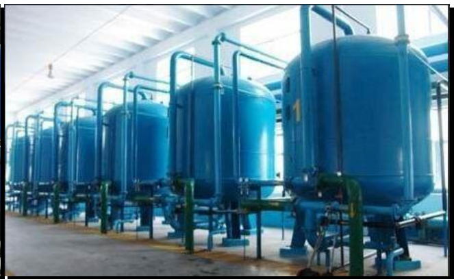
活性炭过滤器
