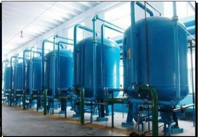
100T/H 活性炭过滤器
