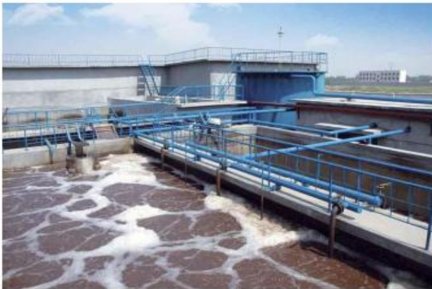
综合工业污水
