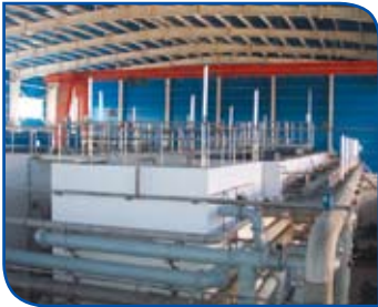
中国 北京奥运会清河污水回用水厂 80,000 m 3 /d (2006)
