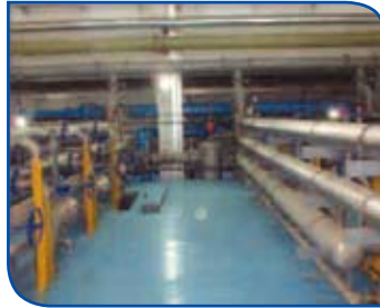
中国 大同第二发电厂回用水厂 17,000 m 3 /d (2004)
