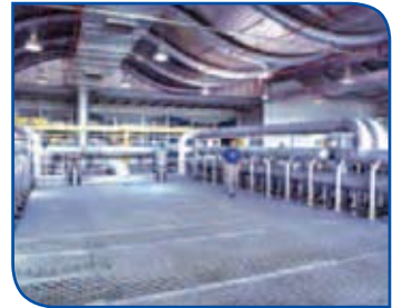
新加坡 Bedok 新生水厂 42,500 m 3 /d (2002)
